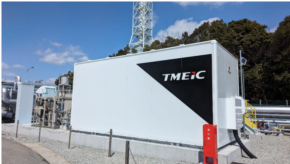
SOEC水素製造用整流器(中央のコンテナパッケージ)
