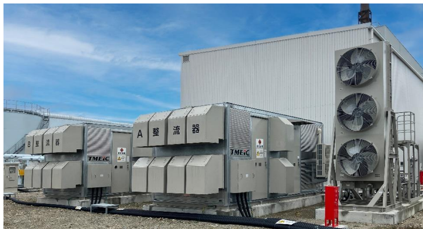
水素製造用整流器(左・中央)と整流器用冷却装置(右奥)
