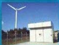
図2: 3000kVA 風力発電用無効電力補償装置
