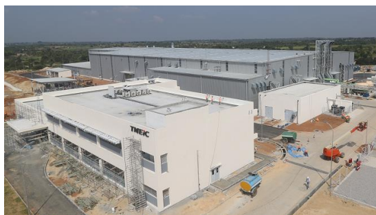
図1 モーター工場 カルナタカ州 バンガロール地区工業団地
